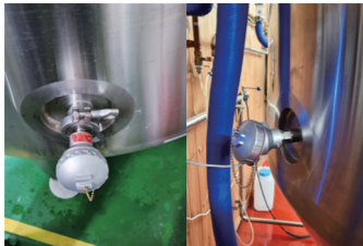
살균탱크 온도 센서 설치 모습
